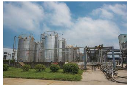
华科聚合物工厂储罐区
